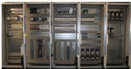
Quadros de Controlo
