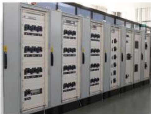
Quadros de Distribuição de Energia
